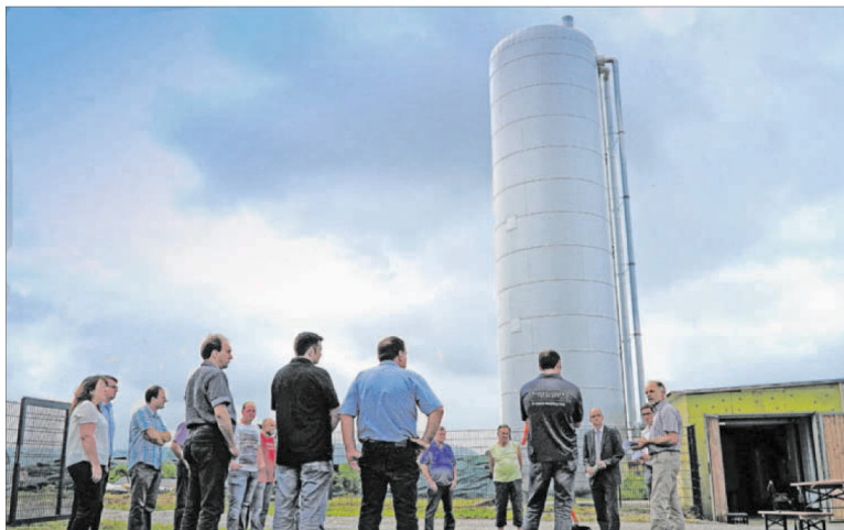
Er ist 14 Meter hoch, 100 Tonnen schwer und hat es gerne warm: der neue Pufferspeicher der Biogasanlage in Uttenhofen soll helfen, die Abwärme aus der Anlage besser auszuschnöpfen. Foto: Beatrice Schnelle
