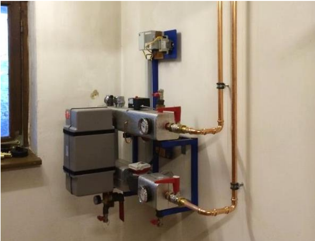
Hausübergabestation im Heizungskeller
