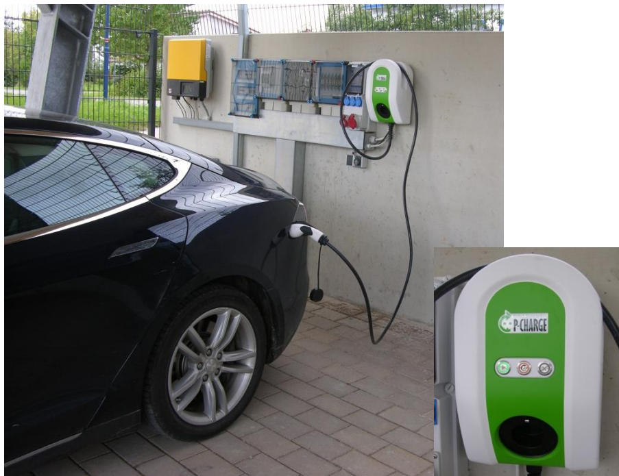
Ladevorgang an der neuen Solarstrom-Ladestation
